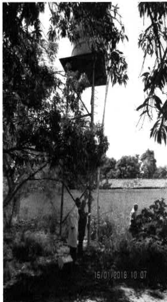
Fig. 68 – Poço Piripiri dos Galdinos – Pov. Cerâmica Cil – Reservatório de fibra, localizado na área do poço, sem informações de última lavagem
