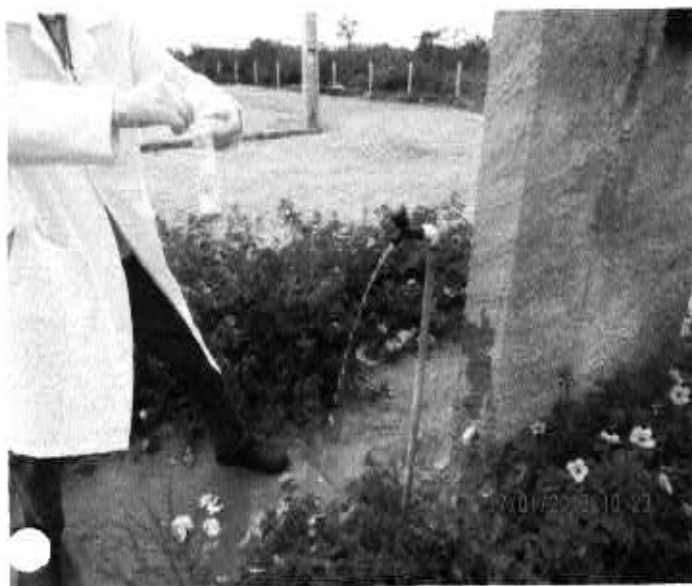
Fig. 32 – Torneira da rede de distribuição – Centro de Reservação Eduardo Costa
