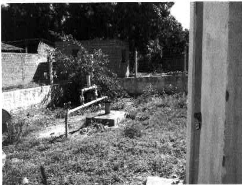
Fig. 41 – Poço 02 – Pov. Boa Hora – com aparelho dosador de cloro instalado e realizando tratamento da água. Possui barreiras sanitárias contra infiltrações.
