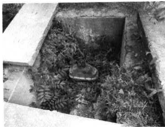
Fig. 10 – Chave de abertura de adutora com local aberto. Local que pode ocasionar acidente. Centro de Reservação Buenos Aires
