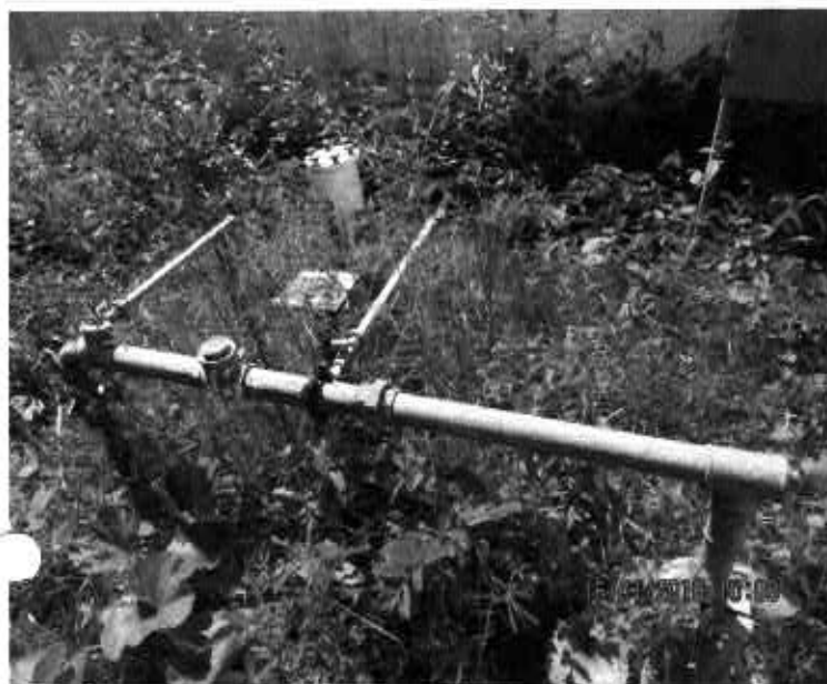
Fig. 67 – Poço Piripiri dos Galdinos – Pov. Cerâmica Cil – Poço coberto pela vegetação, há barreira sanitária contra infiltrações, há dosador de cloro, mas estava desabastecido.
