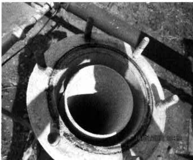
Fig. 75 – Poço 02 – Pov. Cerâmica Cil – Aparelho dosador de cloro desabastecido no momento da coleta.
