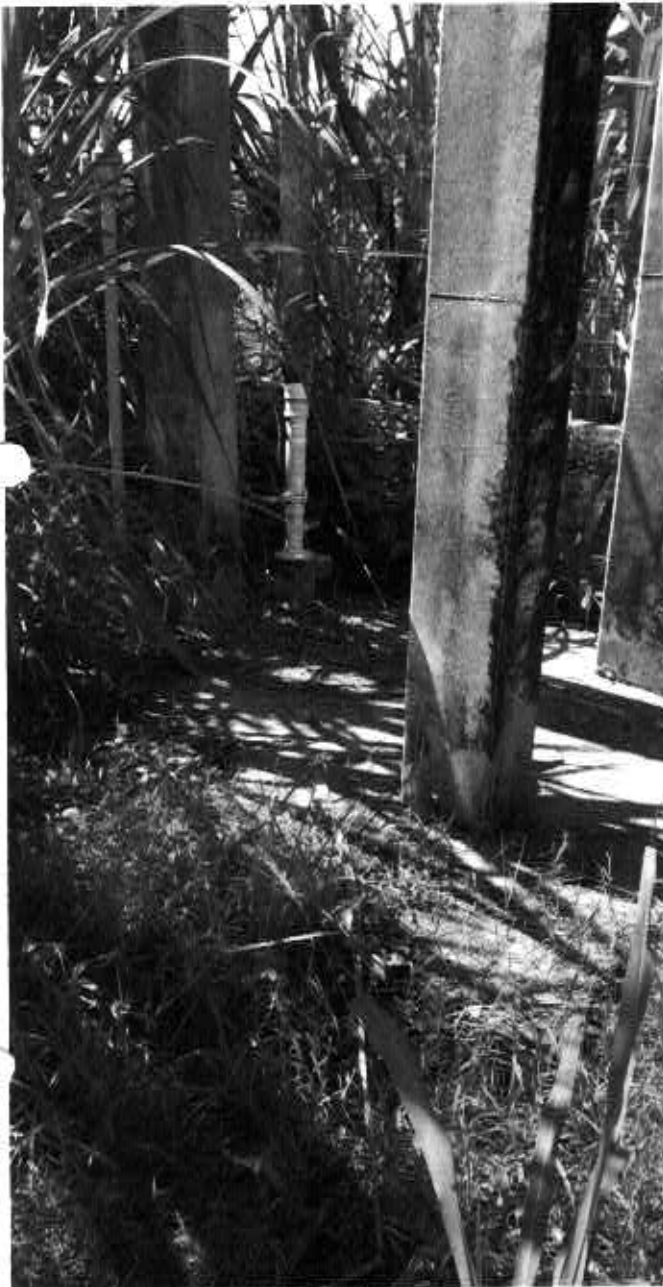
Fig. 42 – Poço Pov. Elisa Romaro – Poço com aparelho dosador de cloro instalado, mas no momento da coleta encontrava-se desabastecido (falhas no tratamento de água). Possui área delimitada, mas precisa-se realizar a retirada da vegetação da área.
