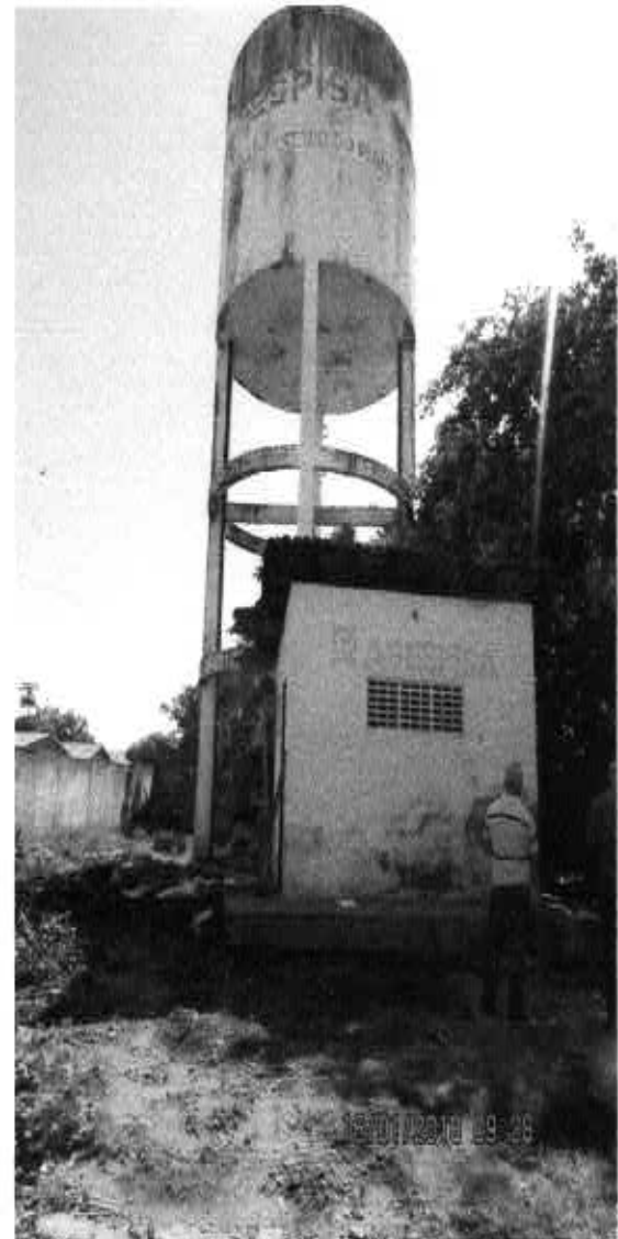
Fig. 71 – Poço 01 – Pov. Cerâmica Cil – Reservatório de concreto localizado em mesmo terreno do poço e sem informações da última lavagem. Casa de Apoio necessitando de reparos.
