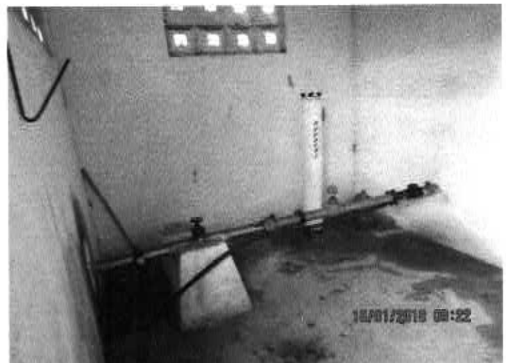
Fig. 52 – Poço 01 – Pov. Serra Dourada – aparelho dosador de cloro instalado dentro da Casa de Apoio, funcionando com dosagem mínima.
