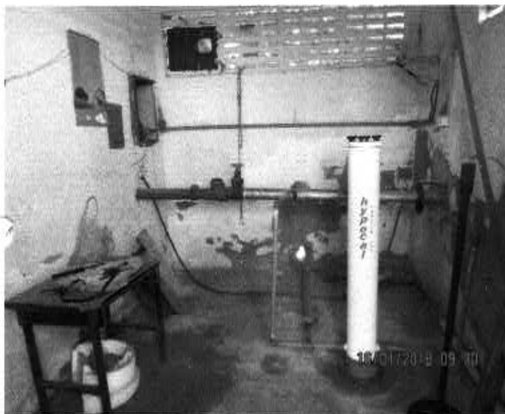
Fig. 72 – Poço 01 – Pov. Cerâmica Cil – Casa de Apoio abriga o aparelho dosador de cloro, o qual não estava abastecido (falhas no tratamento de água) e contendo materiais alheios.
