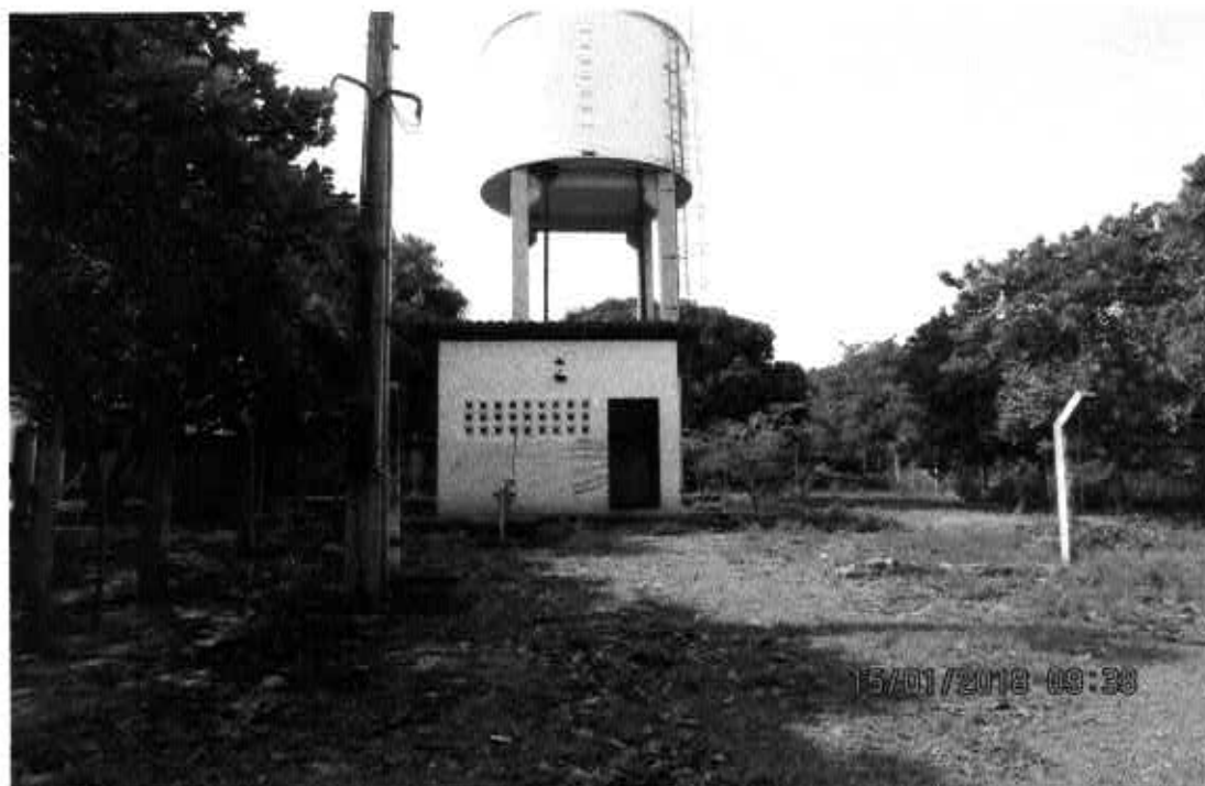
Fig. 57 – Poço 02 – Pov. Serra Dourada – Reservatório de concreto com delimitação de área necessitando de reparos. Casa de Apoio em bom estado de conservação, mas precisando de trancas. Sem informações de última lavagem de reservatório.
