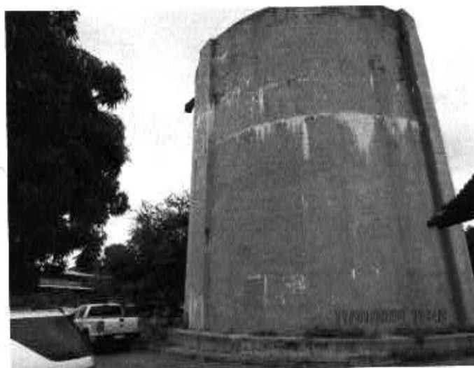
Fig. 11 – Centro de Reservação Morro São João
