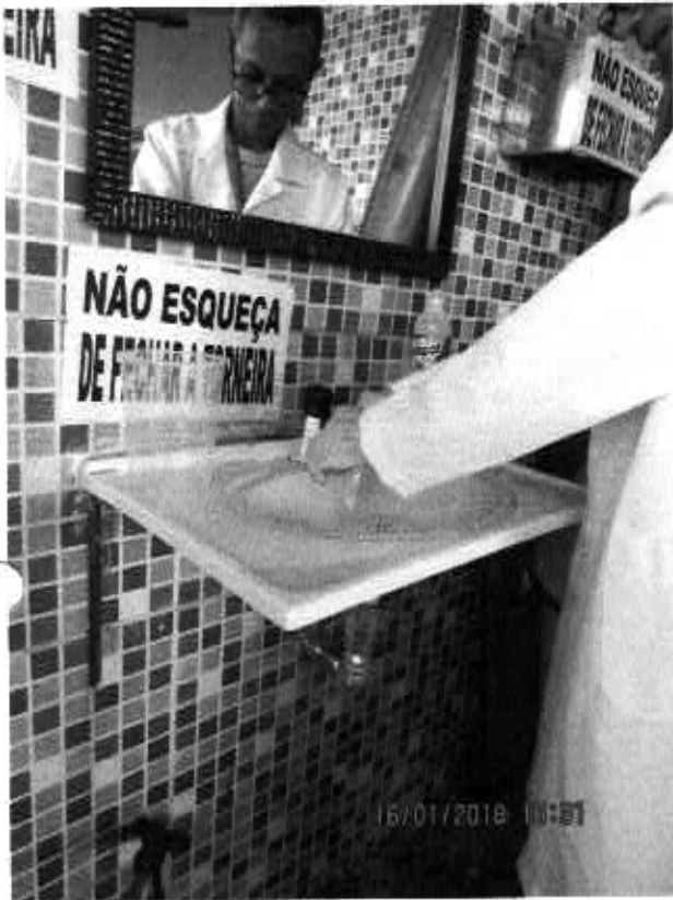
Fig. 29 – Torneira da rede de distribuição. Lanchonete do Hospital de Urgências de Teresina(HUT)
