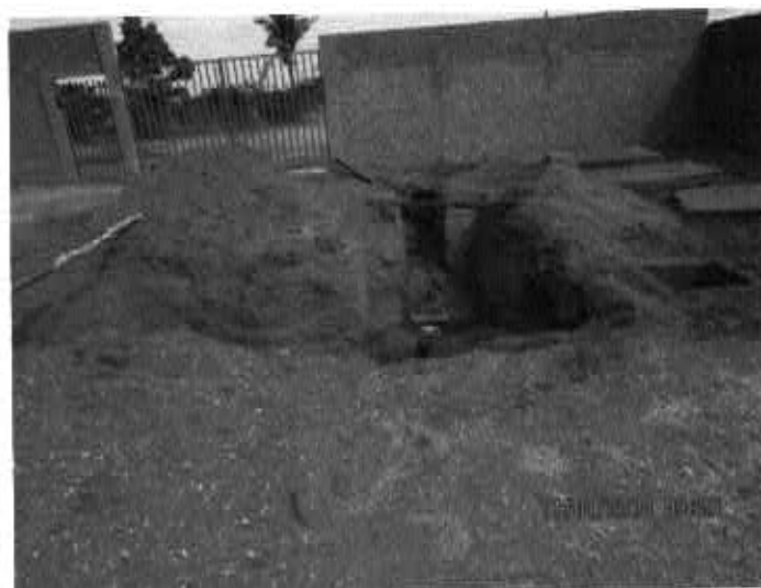
Fig. 14 – Obra sem aviso de segurança podendo causar acidentes. Centro de Reservação Parque Brasil
