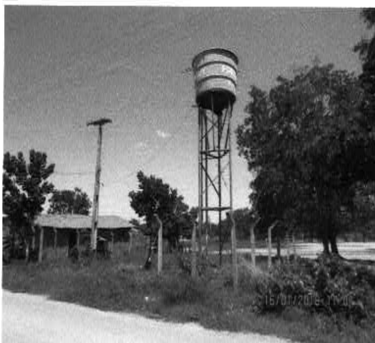
Fig. 78 – Poço Maria Alice – Pov. Cerâmica Cil – Reservatório de fibra encontra-se na mesma área do poço. Sem informações da última lavagem.
