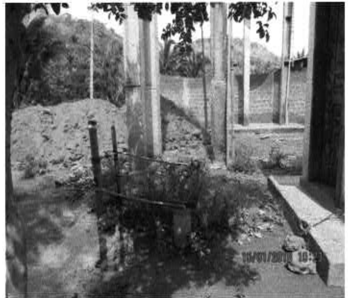
Fig. 54 – Poço 02 – Pov. São João – Há aparelho dosador de cloro instalado, mas não estava abastecido. Não há barreira sanitária contra infiltrações. Área não delimitada e sem proteção.
